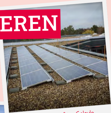
PV Anlage für Schule
