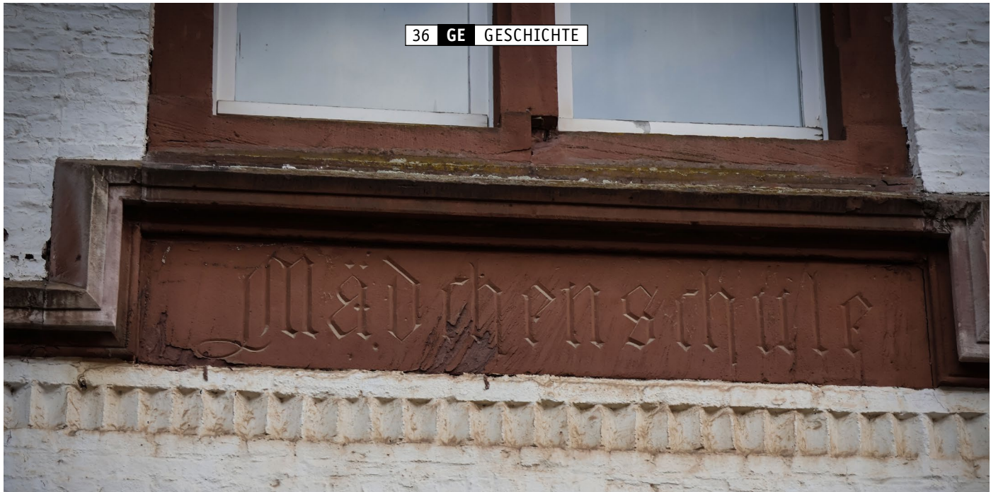
Abb. 1: Über dem heutigen Eingang in den Türsturz eingelassen die Inschrift „Mädchenschule“. Gut erkennbar auch die originalen Gliederungselemente der Fassade wie die auf einem Sockel stehenden Säulen, die die Fensteröffnungen unterteilen, und das umlaufende Gesims mit darunterliegendem Band aus schräg aneinandergereihten Ziegelsteinen.
